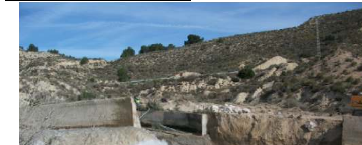
ESTADO INICIAL DEL PICO PATO CAÍDO. APORTE DE ESCOLLERA DE GRAN DIÁMETRO PARA EVITAR MAYORES EROSIONES
