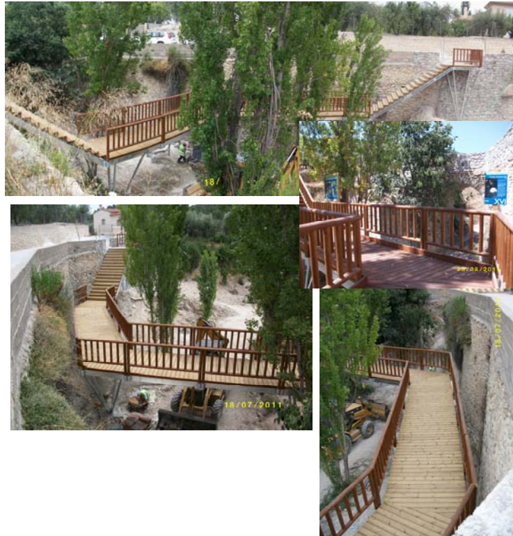
ESTRUCTURA METÁLICA RECUBIERTA PARA EL PASO DE LA SENDA POR EL PUENTE DE JESUCRISTO
